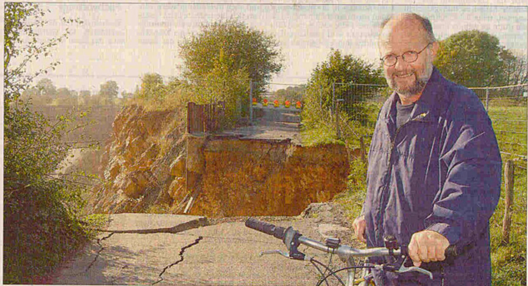
Haarscharf am Abgrund vorbei: Vor den Augen von Stefan Falter stürzte plötzlich ein Straßenstück in die Tiefe.
